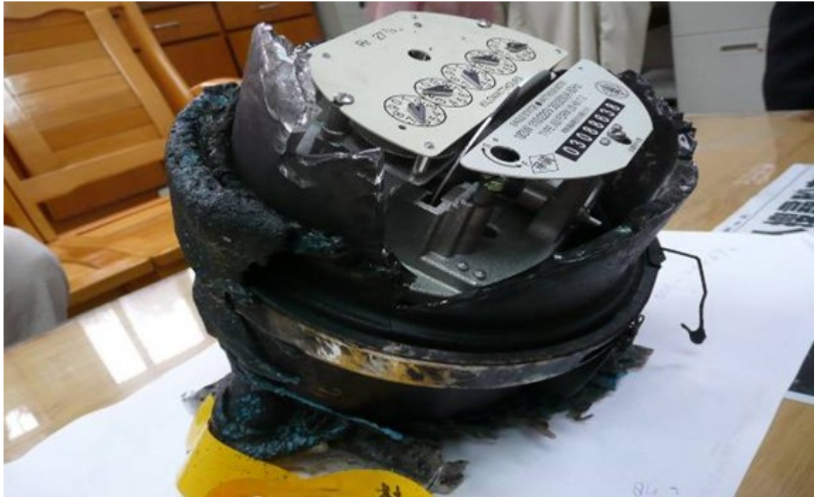
圖3 勘查時熏黑牆面上的電表已換新，經到電力公司鹿谷服務處查看電表燒損情形，發現電表的玻璃面受熱破裂，內部無熏黑，其電路線無短路絕緣披覆無燒痕，顯示電表被延燒到
