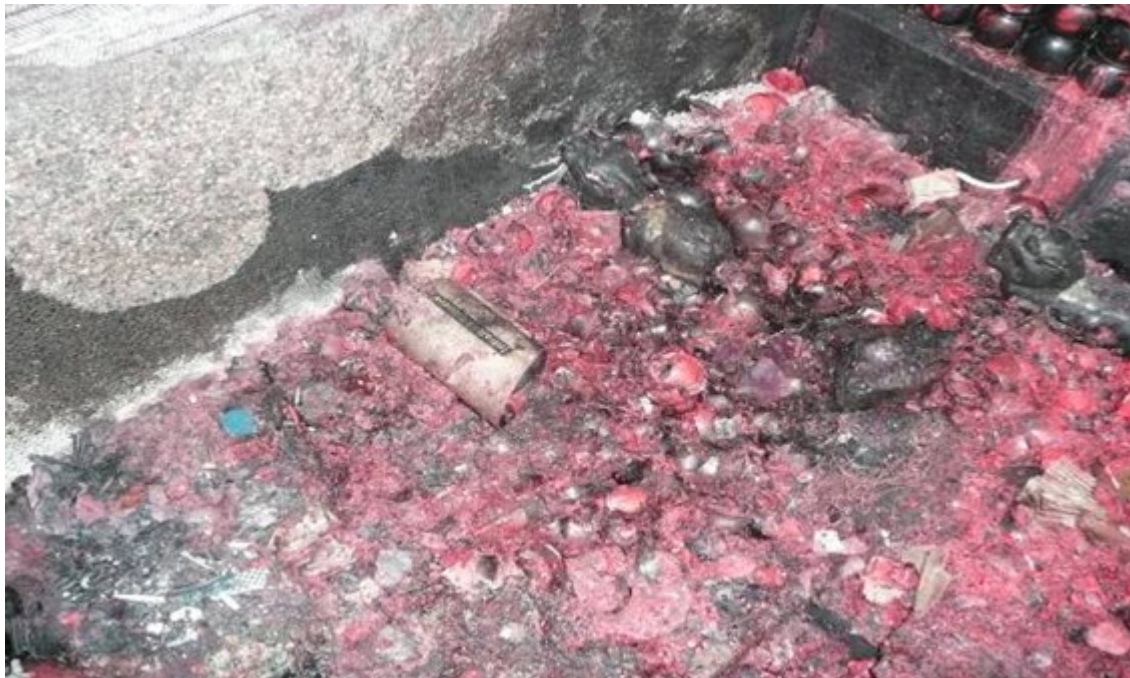
圖2 門亭北側下方燭杯箱與北側牆之間夾角放置的酥油瓶燒失、粉刷牆面部分剝落，牆上監視器鏡頭燒落，監視器無短路，這顯示監視器是被延燒後掉落
