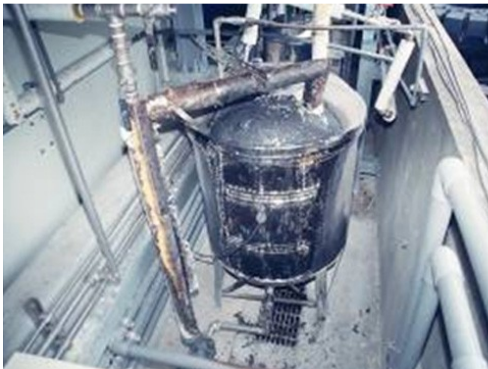
圖 5：廠區南側水溝人孔處有受熱、變色
