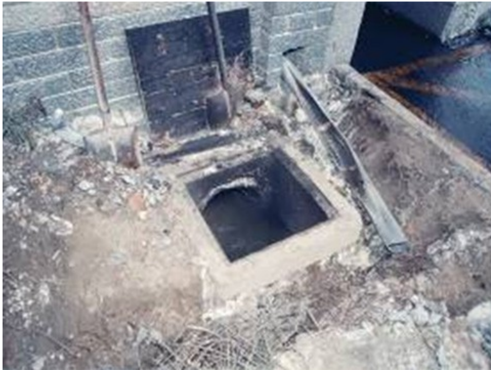
圖 2：工廠廠區南側西端水溝人孔處有受熱、變色
