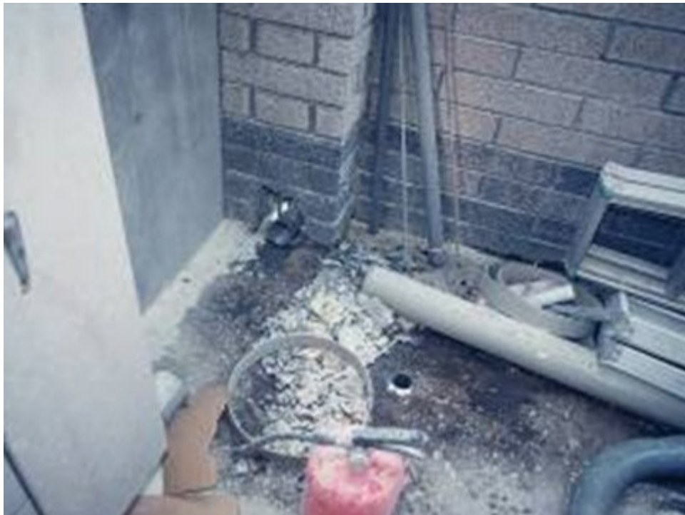
圖 3：廠區南側西端（內側）牆壁孔洞有受熱、變色
