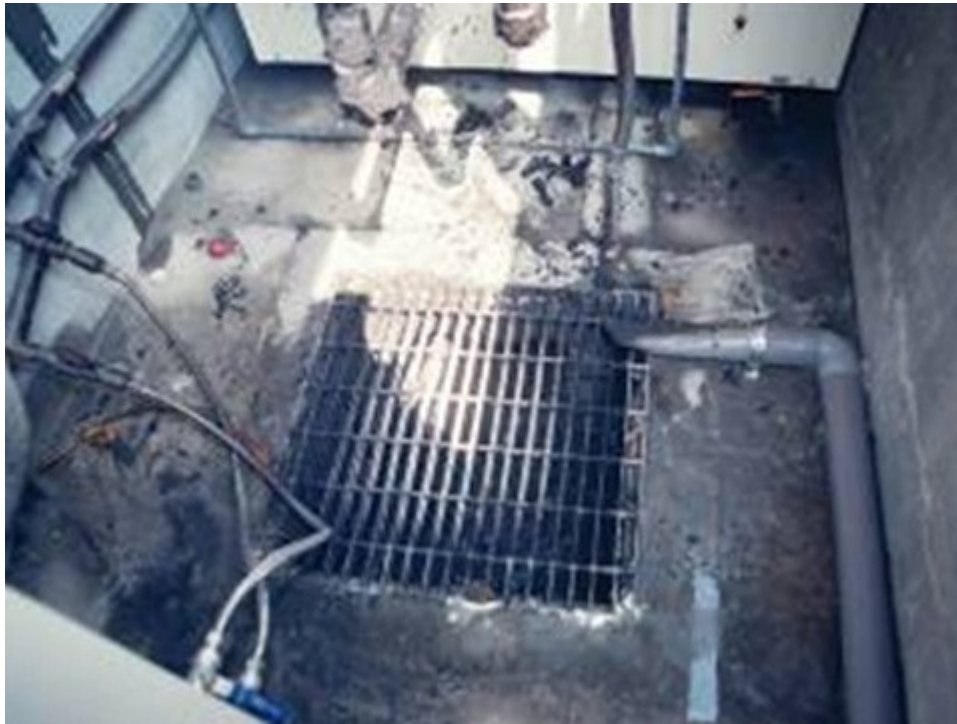
圖 4：廠區南側水溝人孔處有受熱、變色
