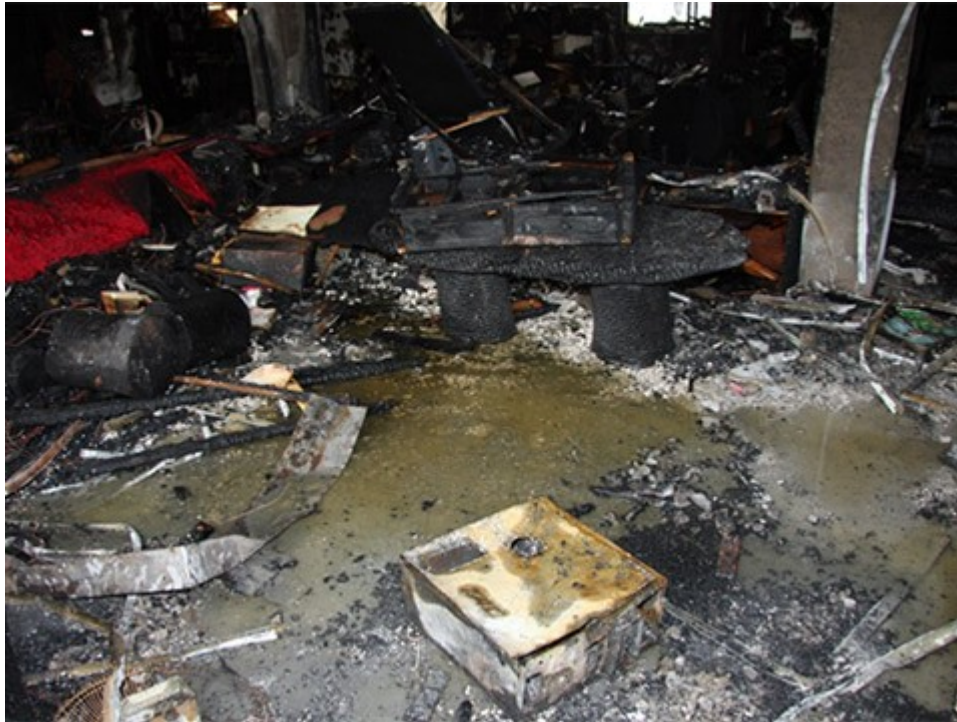
圖 2：以 2 樓南側客廳中間實木茶几附近燒損碳化最為嚴重
