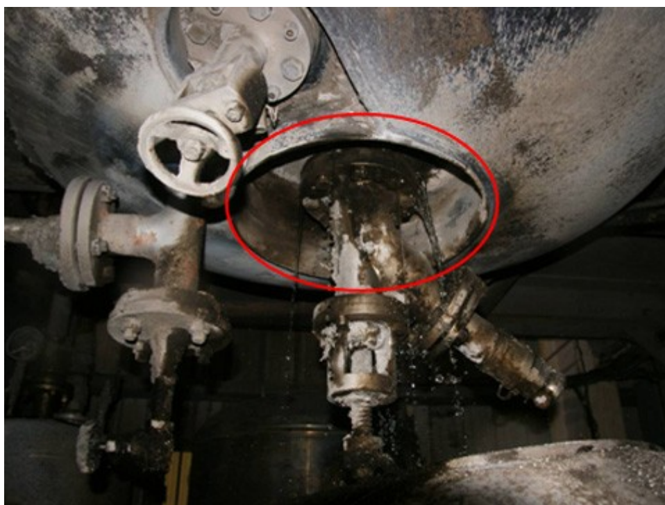
圖 2：反應槽底部桶底閥、旁邊熱媒油管線及下方承接原料白鐵桶均有洩漏噴濺燃燒痕跡
