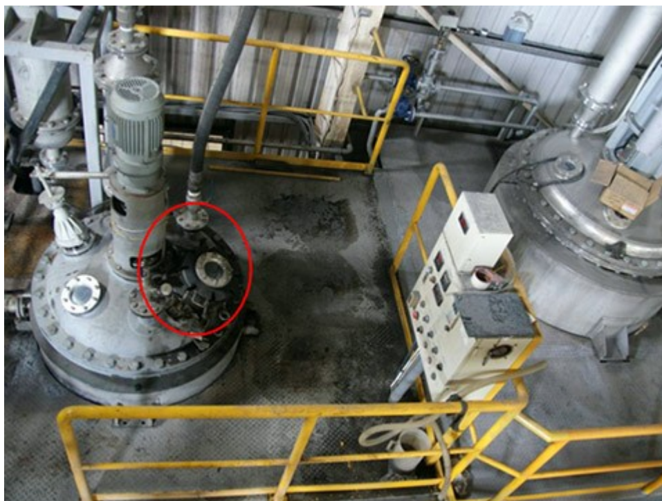
圖1：由高處勘查作業區受燒情形，發現反應槽體頂蓋輕微受燻黑
