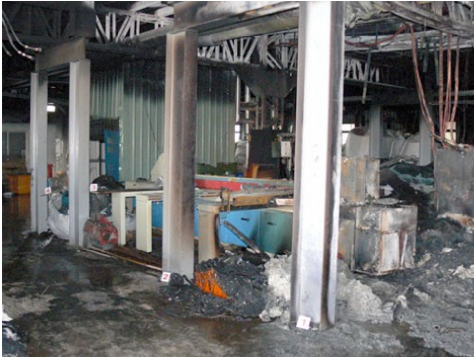
圖 4：大門內編號 1 鋼柱旁附近工字鋼骨柱及天花板鐵架樑受火延燒變色反白。
