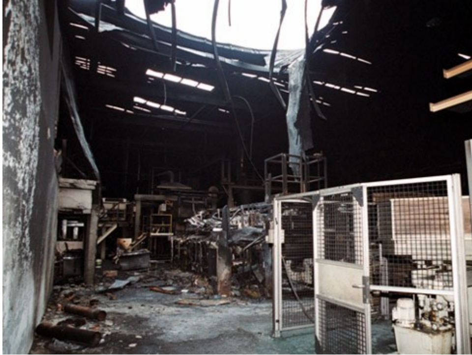
圖 1. 廠房 2 樓縱向延伸機及屋頂鐵皮嚴重燒損
