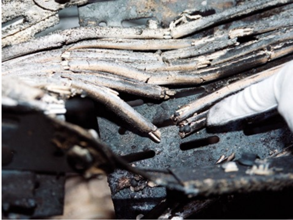
圖 7. 第 1 預熱輪位置上方之電源線有圓球熔痕；線槽有孔洞
