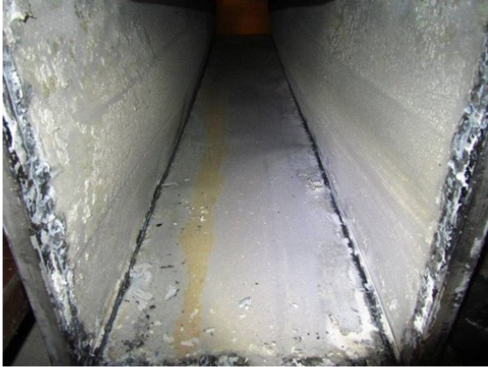
圖3：移除溫度感熱閘門後發現排煙管內壁亦嚴重燒黑變色。
