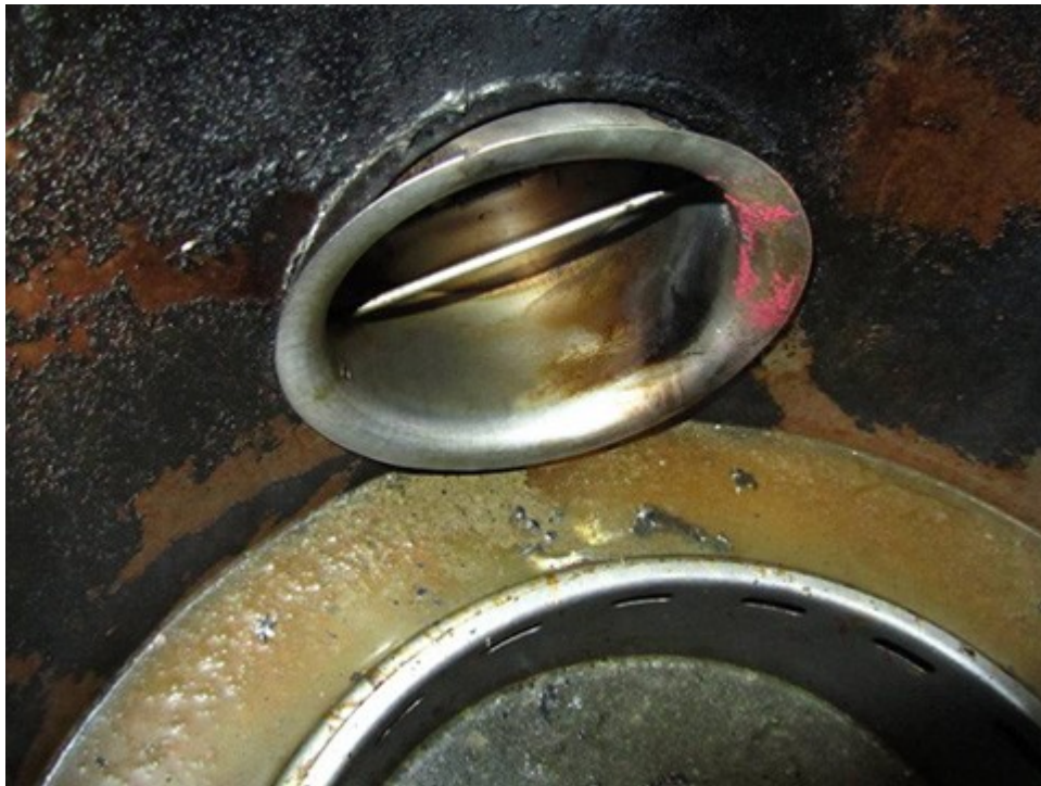
圖1：勘察B13桌位碳烤爐，發現裝置於爐壁上之排油煙管口處金屬溫度感熱閘門有嚴重受燒變色情形。
