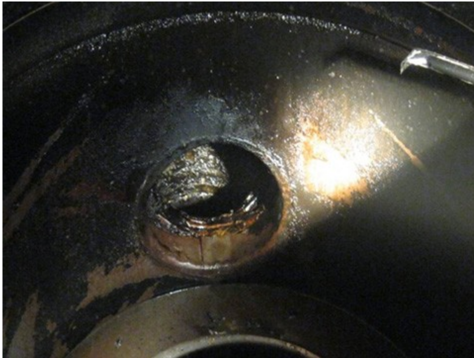
圖 2：移除溫度感熱閘門後發現排煙管內壁亦嚴重燒黑變色。
