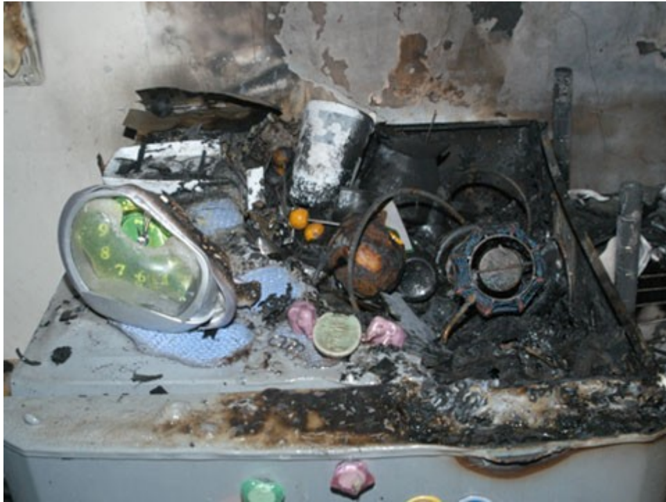
圖 5：冰箱上方正面燃燒後情形。
