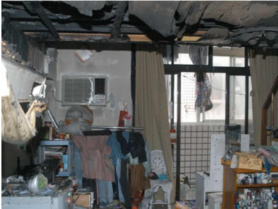
圖 3：起火戶南側，夾層下方裝潢碳化脫落。
