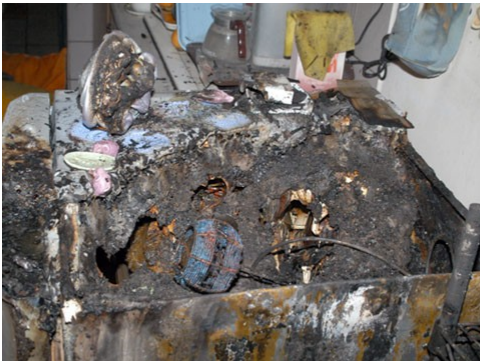
圖 6：冰箱上方南側燃燒後情形。
