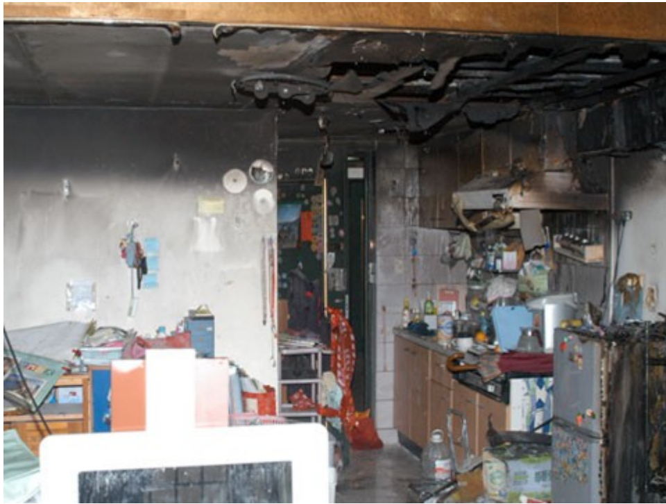
圖 1：起火戶北側，夾層下方東側受燒嚴重。
