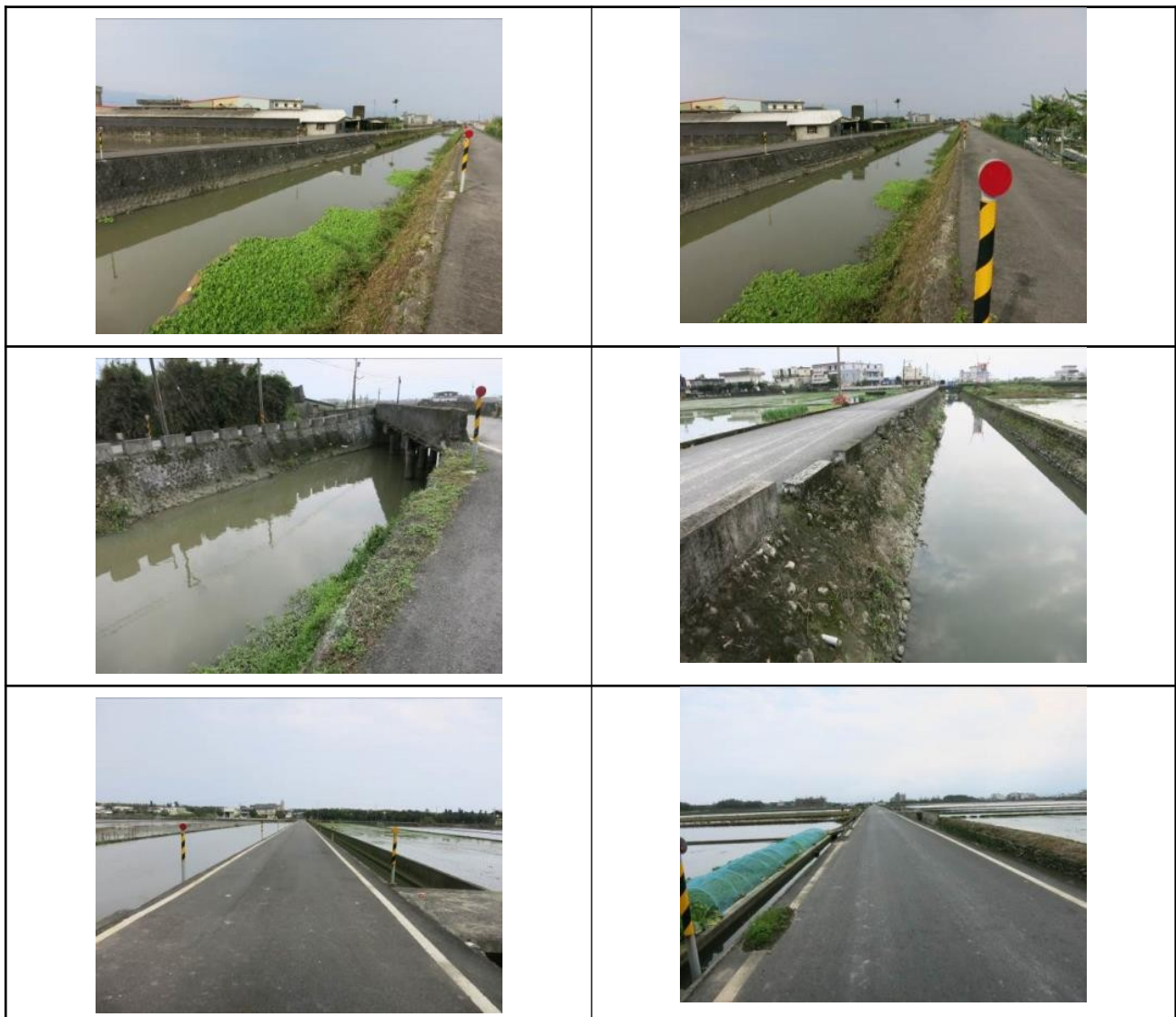
壯圍鄉十三股排水上游3處護岸颶風災害點現勘照片
