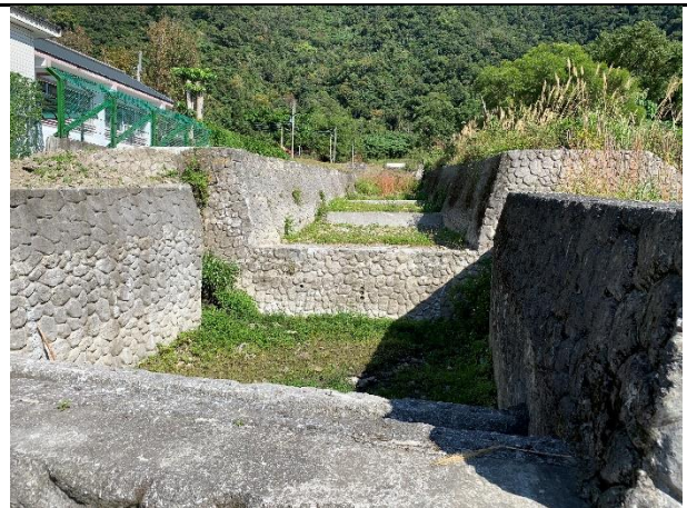
4. 溪流類型 2：(說明：野溪上游沉砂池已完成)
