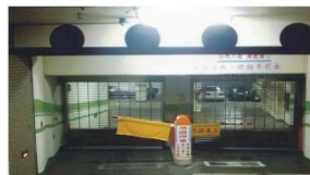
車道自動鐵捲門
