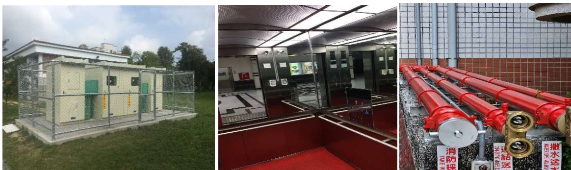
圖 38：南投院區改善耗能用電&電梯與消防等設備汰換 資料來源：本學院
