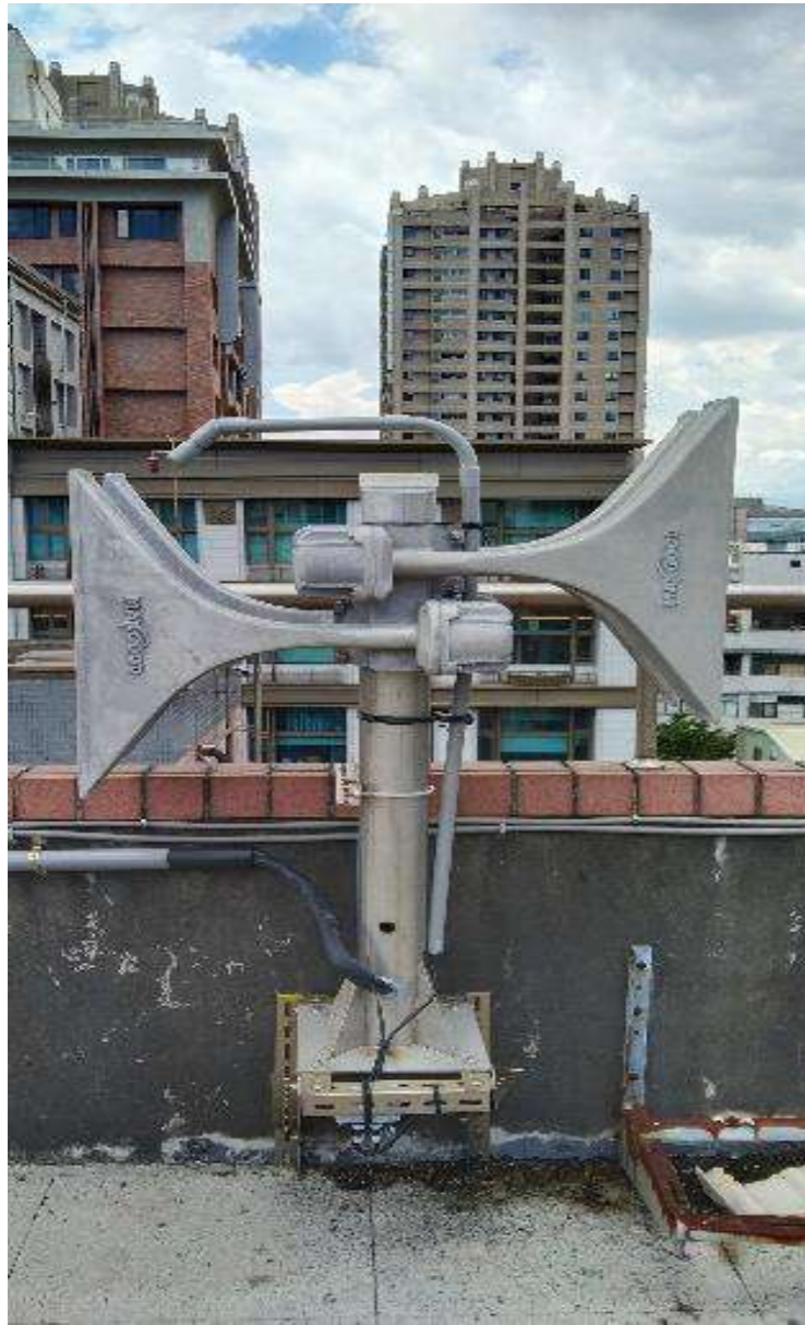
實體警報臺發送警報 全臺共327臺
