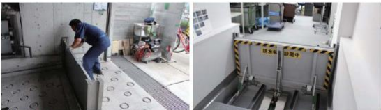
①駐車場の止水板
