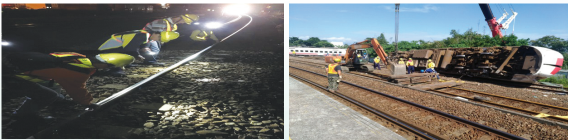
圖1-12 1021鐵路事故現場救災狀況
