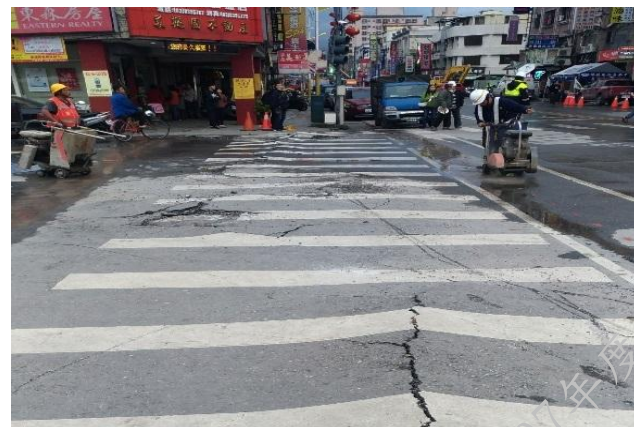
商校街/進豐街路面多處裂縫、擠壓隆起
