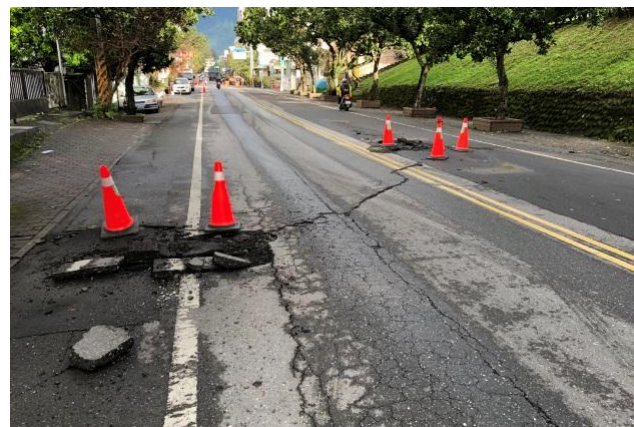
明禮路路面破損及多處裂痕
