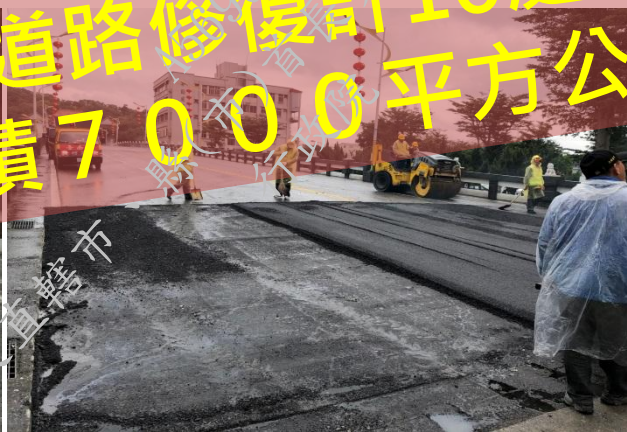
依破壞情形以機具將橋面分段局部破碎並重新鋪設路面
