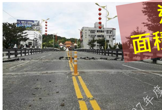
尚志橋橋面多處裂縫、破損
