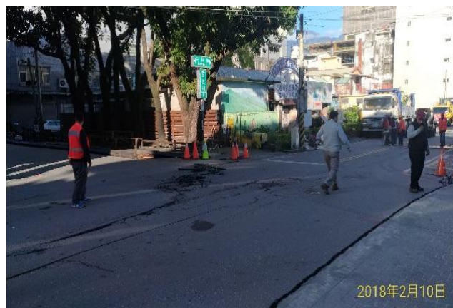
三民街路面多處裂縫、擠壓隆起
